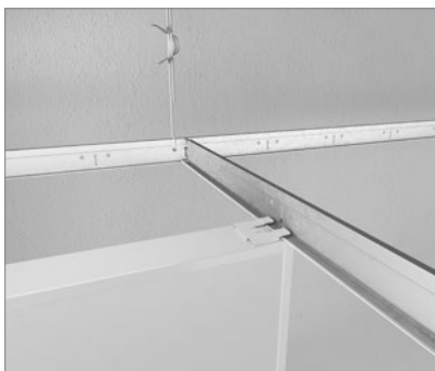
Rockfon Universal Baffle correctement fixé au profilé Chicago Metallic T24 (les deux languettes encliquetées sur le rebord du profilé T24).
